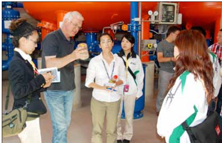
Georg Krebs erläuterte den Besuchern, mit welchen Filtertechniken gearbeitet wird, damit aus dem Schweriner Grundwasser Trinkwasser wird Foto: maxpress/mu
