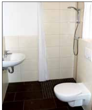
Bodengleiche Duschen erleichtern gerade Älteren die Nutzung
